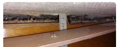
Obergeschoß: Spalt zwischen Fußboden und Außenwand durch Ausbauchung der Außenwand und/oder Durchhang der weit gespannten Erdgeschoßdecke.
