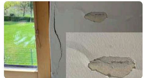
Ordination: Quetschung des Innenputzes an der Außenwand in Folge der Wandverformung,
